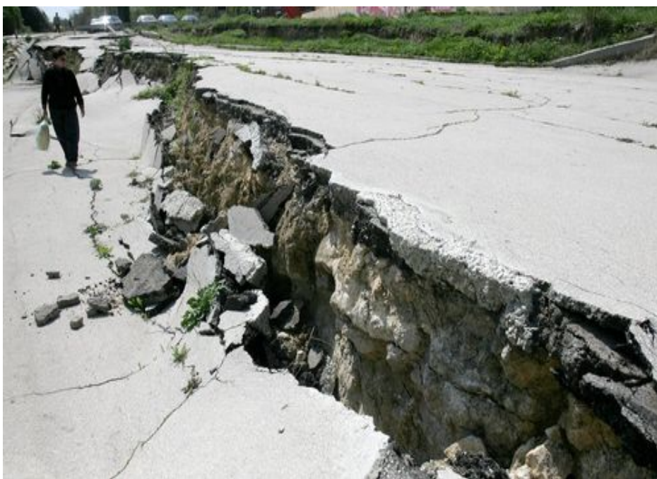
Photo. 1 Landslide near the restaurant “Triphon Zarezan”, north of Varna, year 2008 / Alunecare în apropierea restaurantului „Triphon Zarezan”, la nord de Varna, 2008
